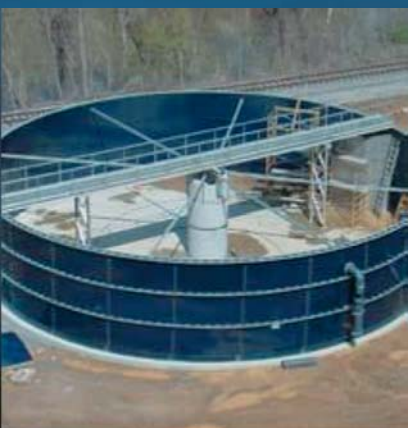
Armazenamento / Mistura de lodo
